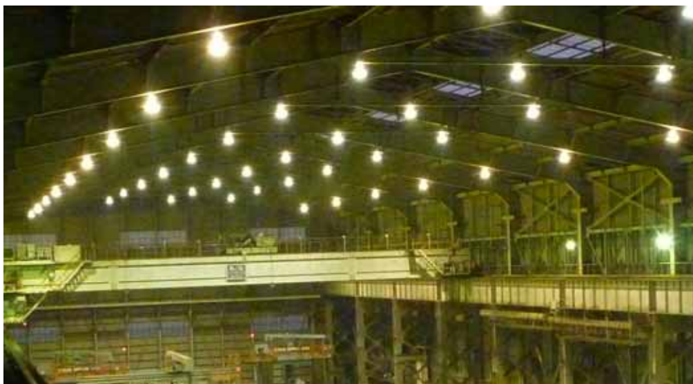
【玉野事業所 重機工場内 照明高効率化後 設備状況】
